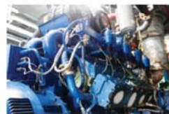
716 kW el BHKW
